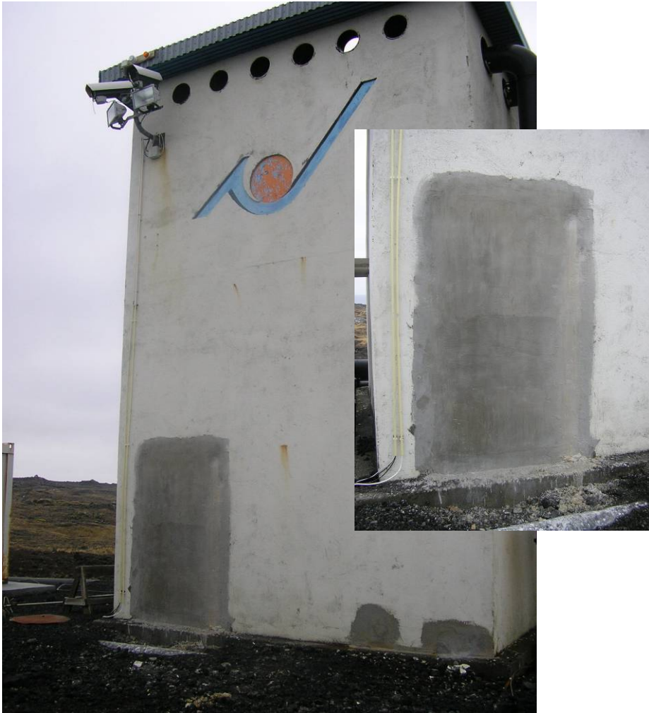
Mynd 24. Hurðarop á vatnstank eftir meðhöndlun með XYPEX. Engan leka er að sjá í samskeytum milli hurðarops og veggjar.
