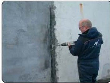
Fjögurra sentimetra djúp og fjögurra sentimetra breið rauf er höggvin þar sem lekinn er og töluvert vatn vætlar út.
