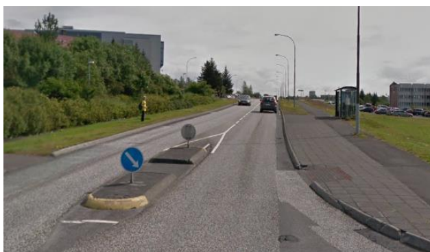
MYND 27 Viðeigandi merkingar vantar við gangbraut strætóstöðvar við BSÍ
