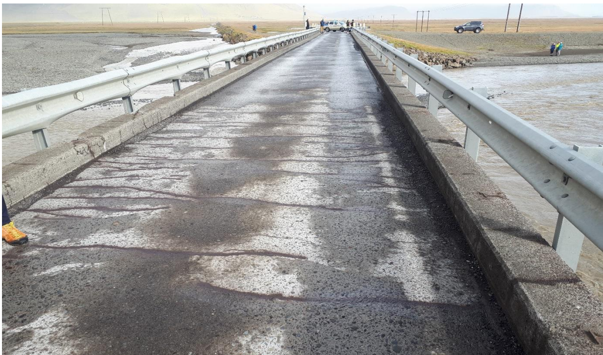
Mynd 2 – Sprungur í efra byrði yfirbyggingar þar sem flotliðir mynduðust.
