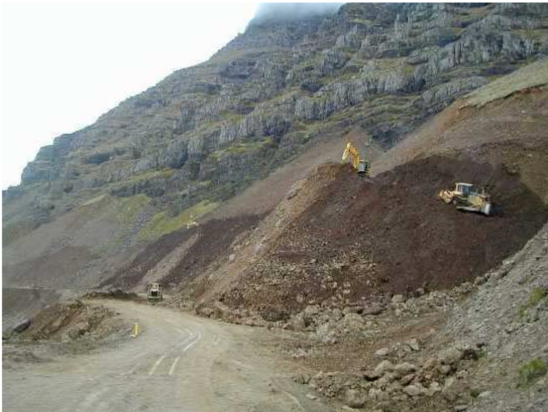
Mynd 7. Grjóthrun er hættulegt í Kambanesskriðum. Unnið að lagfæringum.
