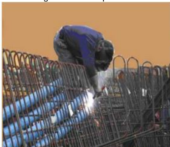
Abb. II.17: Schweißen ohne Schutzmassnahme ist untersagt.
