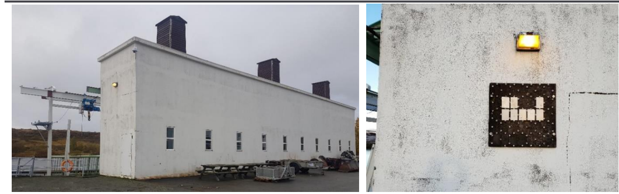
MYND 4 Tæringarrekki á gafl lokuhúss Írafossvirkjunar.
