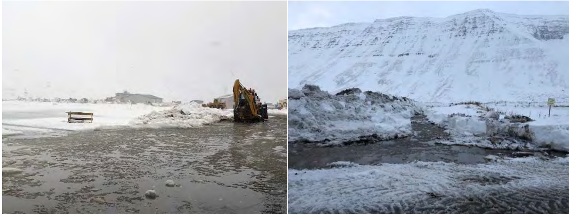
Mynd 17. Svæðið var drenað með gröfu og við það minnkaði vatnið. Tunnan var látin standa aðeins meira upp úr jörð en áður til að minnka líkurnar á að vatn komist inn í hana. Vonandi er búið að draga úr líkunum á því að þetta gerist aftur.
