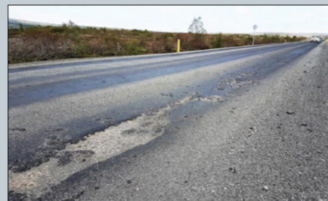
Skemmd vegna blæðinga á vegi 35-08 á Biskupstungnabraut í stöð 5758, rétt austan við Geysi.
