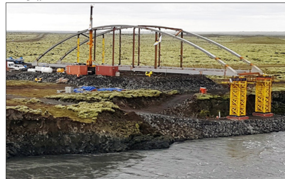
25. maí 2019 kl. 12:05. Gulu súlurnar, bráðabirgðaundirstöðurnar, voru fjarlægðar þegar brúin var komin á sinn stað.
