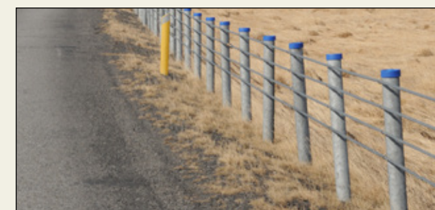
Víravegríð, vegriðsstoðir og vír sem vegriðsbeinir.
