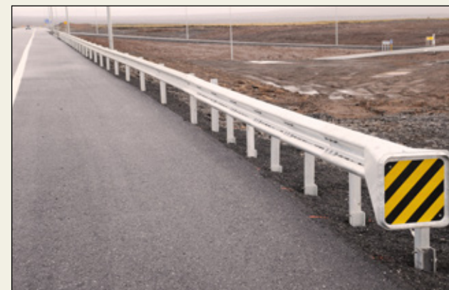
Vegrið, vegriðsstoðir, vegriðsbeinar og dempanði vegriðsendi.
