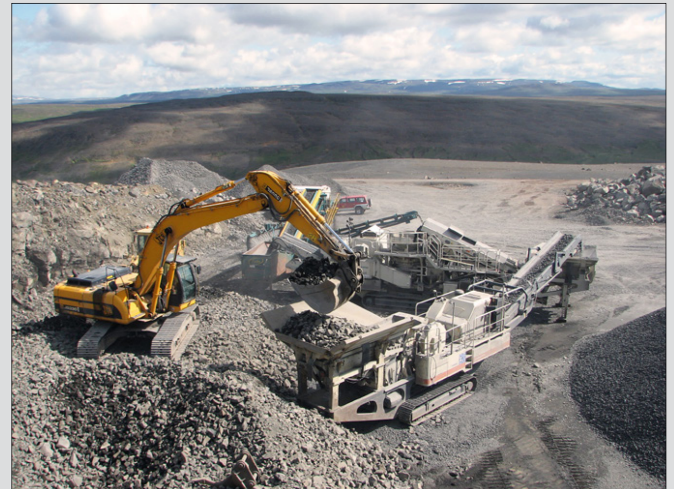
Norðausturvegur, Brunahvammsháls-Bunguflói 22. júlí 2009. Efnisvinnsla 0-20 mm efni. Efni unnið úr kubba- og stuðlabergi. Ljósmynd: Hafdis Eygló Jónsdóttir
