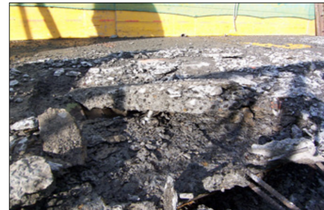
Steypuskemmdir yst í hægri akrein.
