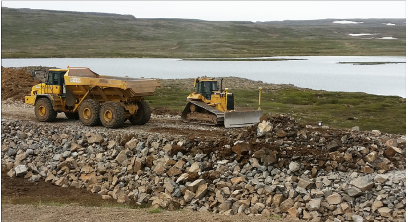
Strandavegur (643), Hálsgrata - Svanshóll. Framkvæmdir á Bjarnarfjarðarhálsi 8. júní 2016. Verktaki er Borgarverk ehf. Ljósmynd: Skúli Þórðarson.
