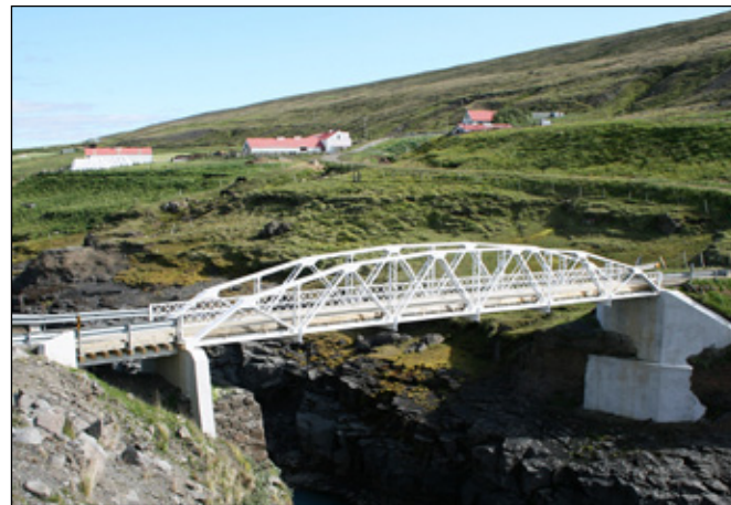
Jökulsá á Brú, hjá Hákonarstöðum á Jökuldal, 27,4 m löng grindarbitabrá + landhaf, byggð 1908. Gerð upp 2008. Stálvirkið var framleitt í Ameríku.
