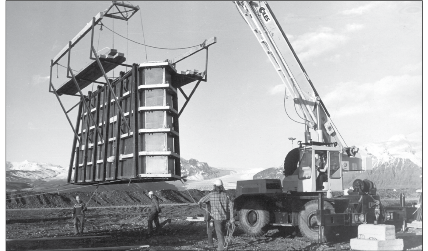
Brú á Skeiðarársandi, mót fyrir stöpla færð til.
