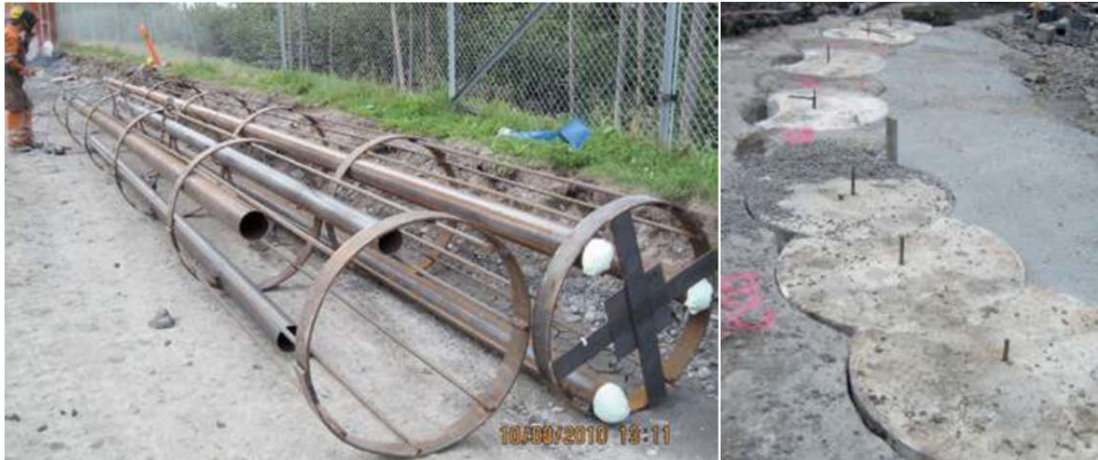
Mynd 15. T.v. járngrind með ásoðnum rörum til að setja niður bolta við botn staura. T.h. sniðmát fyrir borun til að tryggja rétta staðsetningu, hér 250 mm skörun [3].
