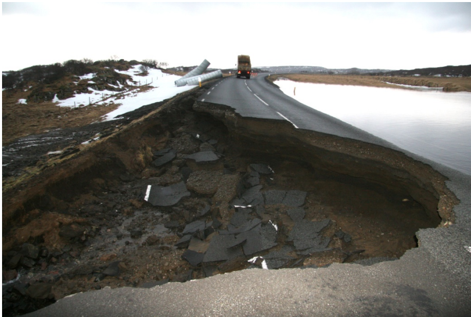
Mynd 2-3 Vatnstjón á Hringvegnum við Daniélslund í Borgarfirði í kjölfar flóðs vegna asahláku 18. febrúar 2008 (ljósm. Skessuhorn)
