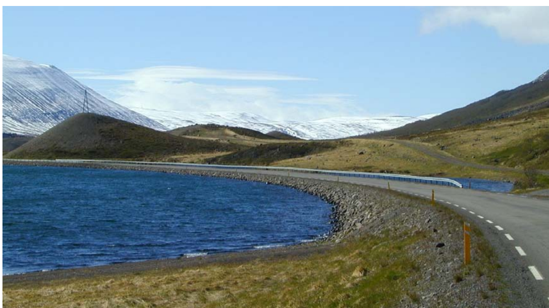
Mynd 10: Þjóðvegur 1 í Suður-Þíngeyjarsýslu. Vegurinn liggur yfir Ljósavatn. Vegrið ætti að vera beggja megin. Brattur flái að hluta og líkur á að bifreið velti og lendi í vatni..
