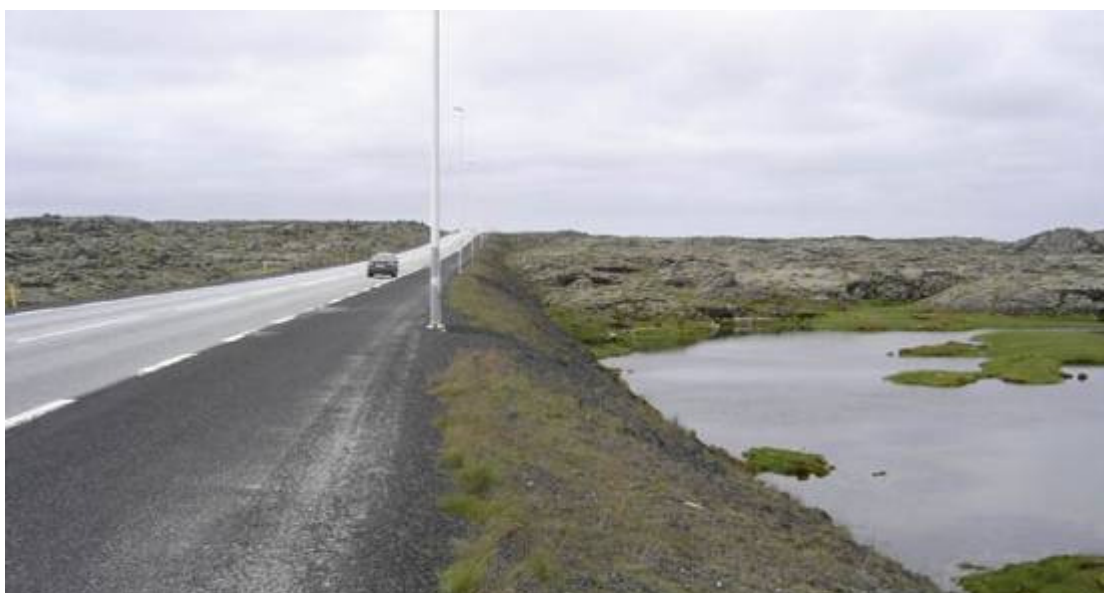
Mynd 9: Við Reykjanesbraut. Hér er brattur kantur og við útafakstur eru mest líkindi á veltu og bíll lendi í vatni.. Vegrið virðist vera heppilegasta lausnin.
