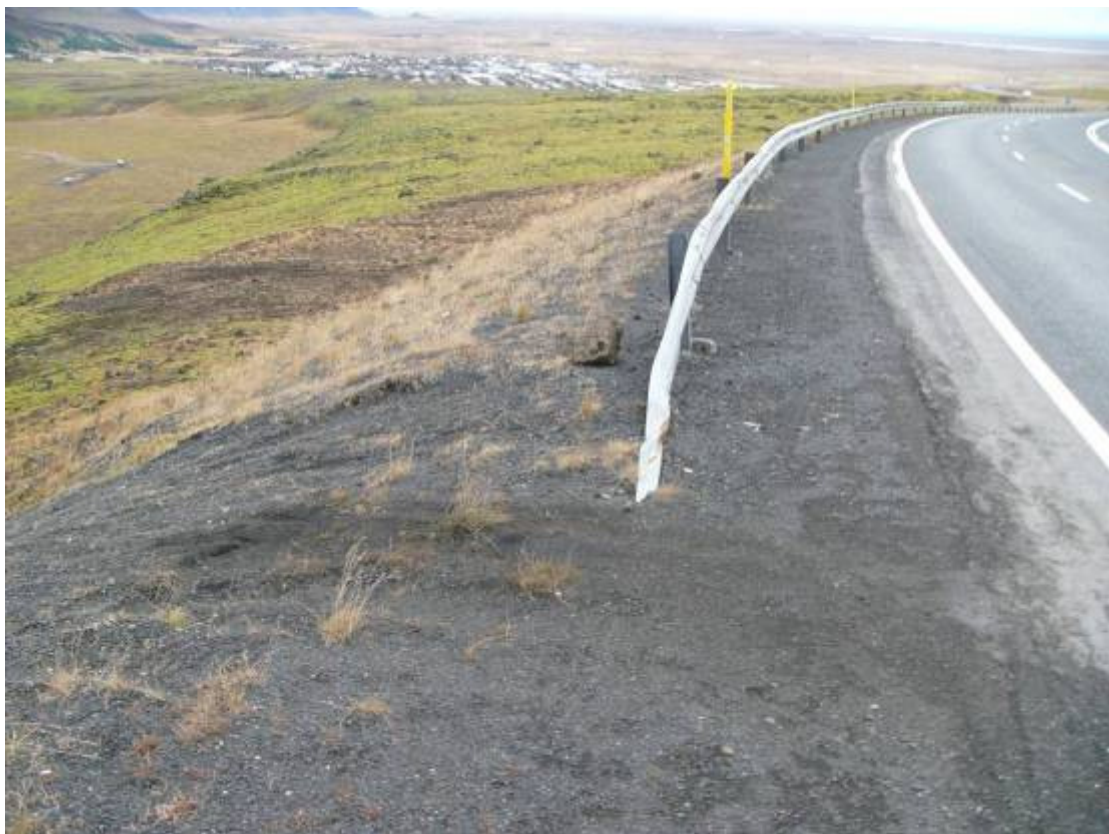
Mynd 4: Suðurlandsvegur. Frágangur vegriðsenda er oft ófullnægjandi. Hér er þó reynt að sveigja vegriðið frá veginum, sem er til bóta.
