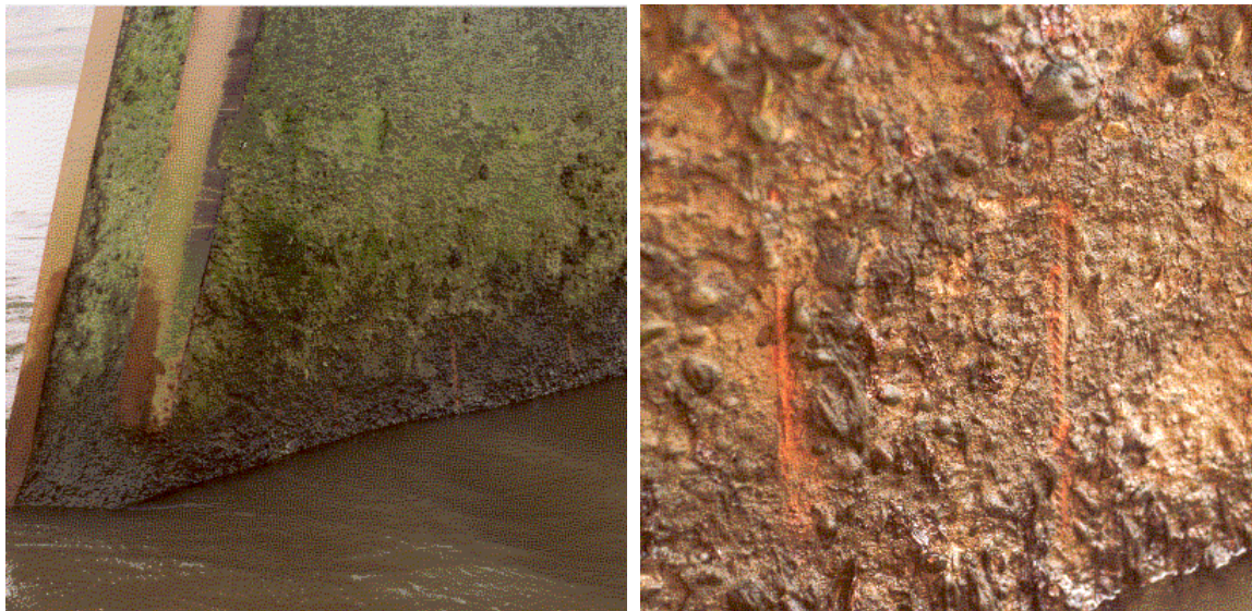
Mynd 1. Óvarið brynvarnarjárn á stöpli (t.v.) og bendijárn (t.h.)
