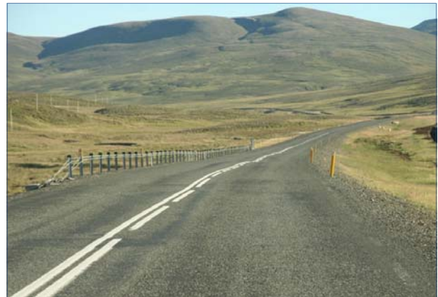
Mynd 9 744 Þverárfjallsvegur, kafli 03 Laxárdalsheiði, byggður að hluta á gömlum vegi, breikkun. Verktaki, Skagfirskir verktakar ehf
