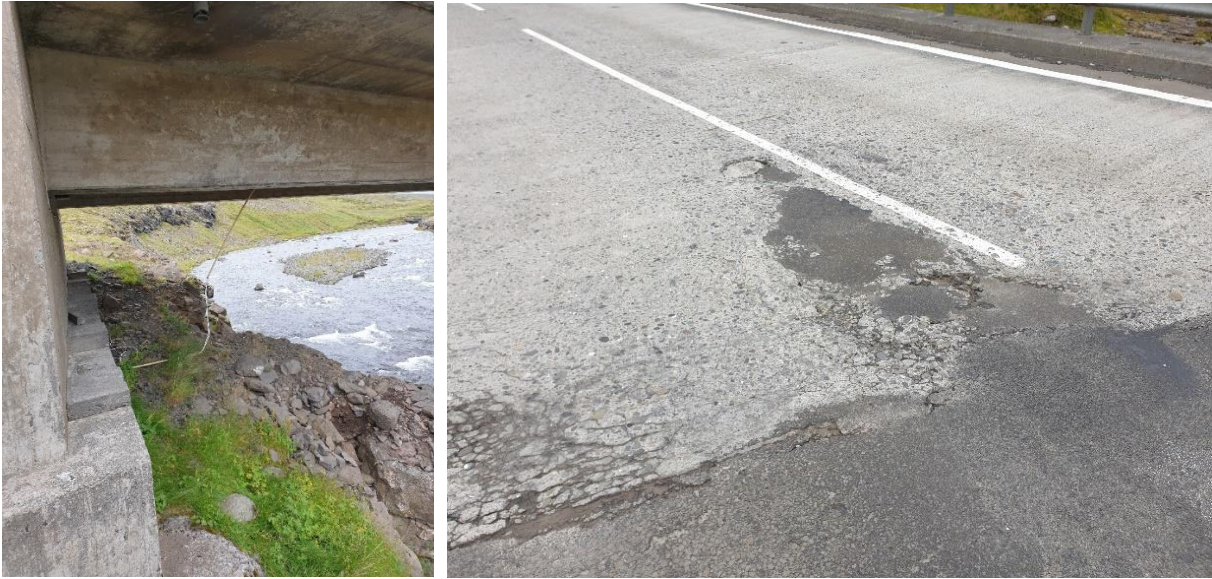
MYND 22 Vestari stöpull, hægt að standa við borun. Skemmdir í gólfi.
