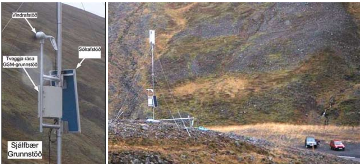
Mynd 3.13 Færanleg tilraunagrunnstöð á Öxnadalshéiði.
