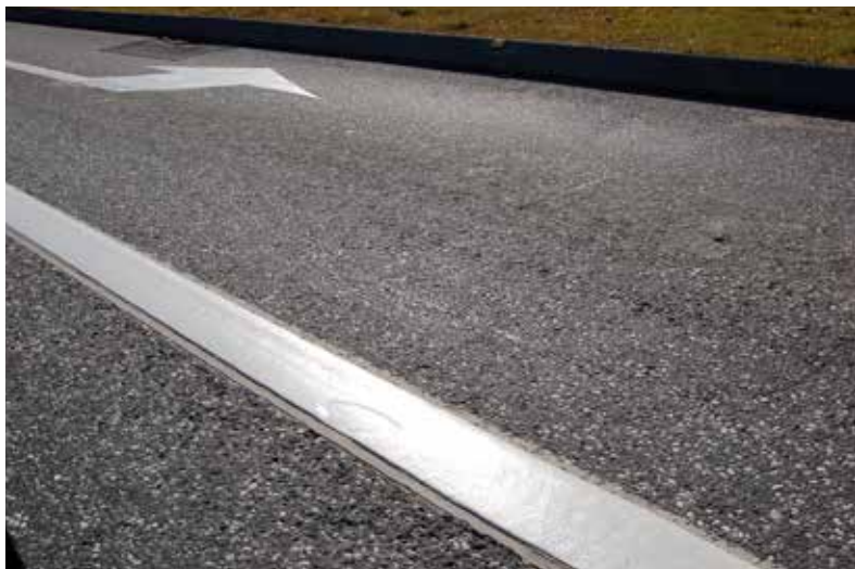
Þykkar vegmerkingar geta skapað hættu.
