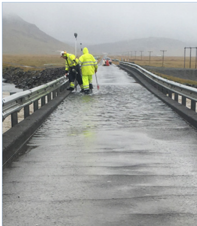
Hringvegur (1), Steinavötn, 30. september 2017. Vatn situr á brúargólfinu þar sem það hefur sigið.
