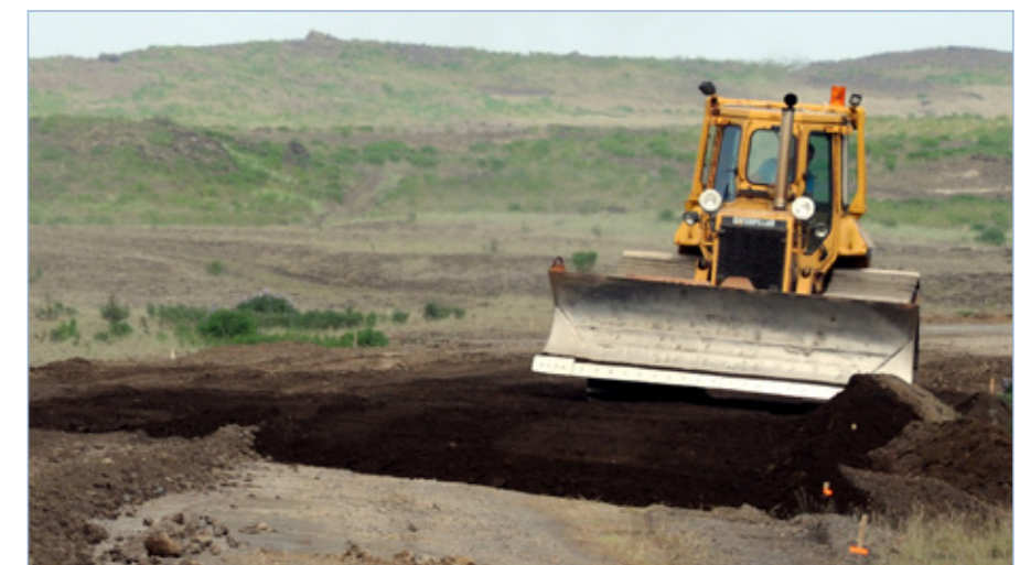
Landvegur (26), Galtalækjarskógur - Þjófafossvegur, 23. júlí 2013.
