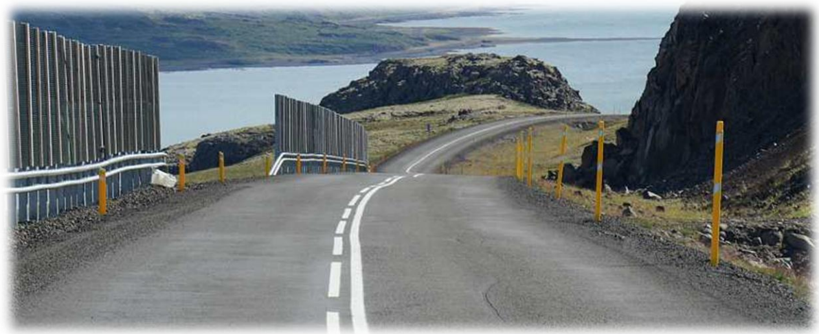
Skemmdar snjóvarnargirðingar á Klettshálsi (GPM).
