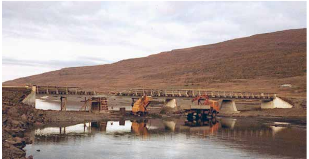
Kelduárbrúin eftir flóðið. Steypa þurfti nýja stöpla undir brúna, sem sópuðust burt í flóðinu. Vegurinn beggja vegna brúarinnar grófst einnig í sundur. Það er nokkur kaldþæðni að sjá Kelduána renna sakleysislega í „Lekjarfarveg“ milli tveggja brúarstöpla og erfitt að ímynda sér að hún eigi það til að flæða yfir þessa brú. Mynd: Vegagerðin
