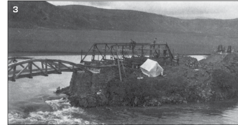
Skaftá, syðri strengurinn, brúargerð 1924. Grindarbitinn settur saman. Brú á nyrðri strengnum sést í baksýn.
