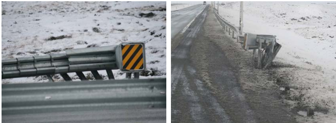
Mynd 8 og 9: Viðurkenndur eftirgefanlegur vegriðsandi, sem ekið hefur verið á.
